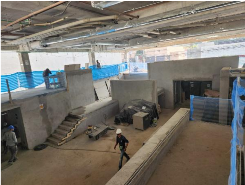
Instalações elétricas e encanamentos
