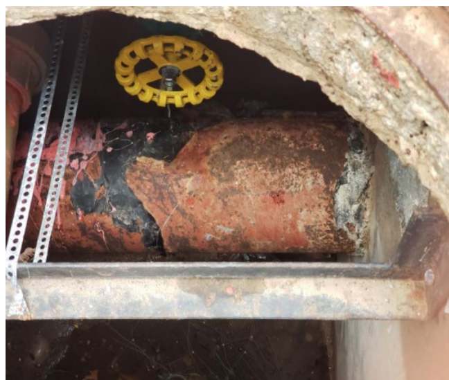
Oxidação na tubulação.
