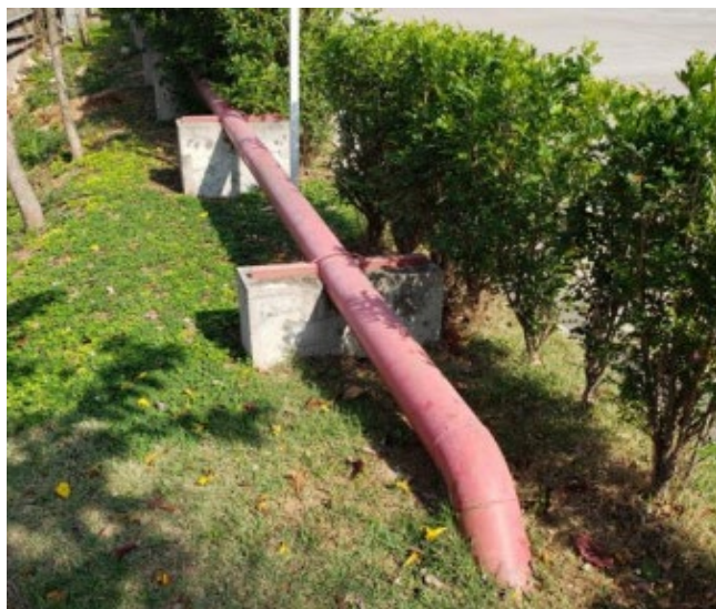
Rede principal de incêndio danificada.
