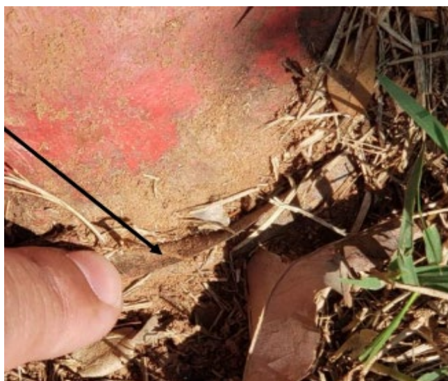
Falta de aderência na fita anticorrosiva.
