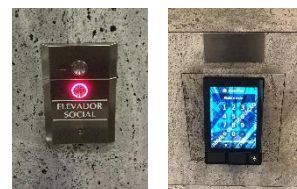
Fotos da antiga e nova botoeira dos elevadores da Torre Oeste
