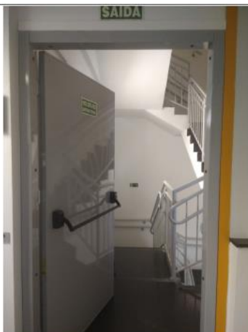
Porta corta fogo com barra antipânico, instalado na escada da agência
