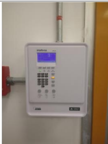
Sistema de alarme de incêndio instalado
