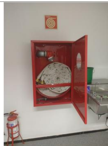
Sistema hidráulico (hidrante) instalado
