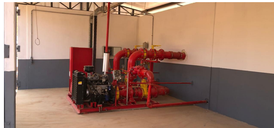
Área Interna da Casa de Bombas
