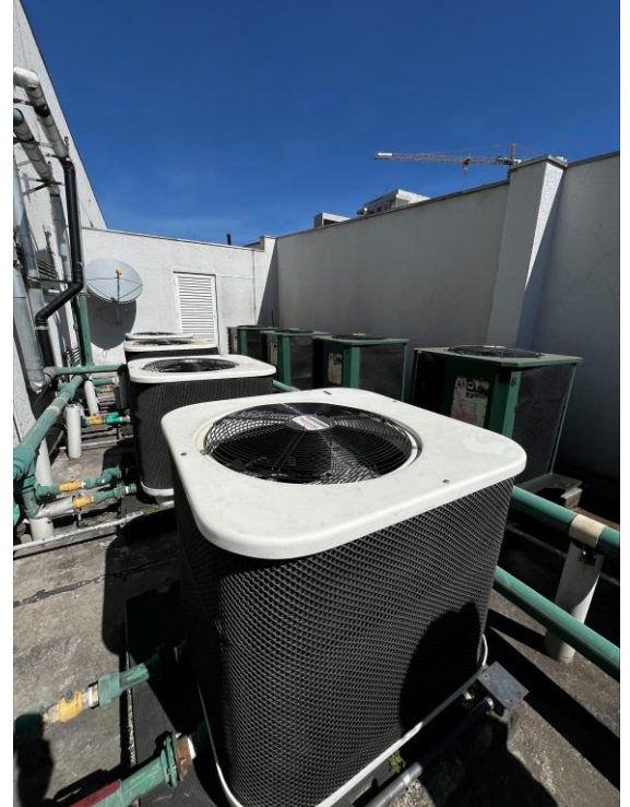
Sistema de ar condicionado
