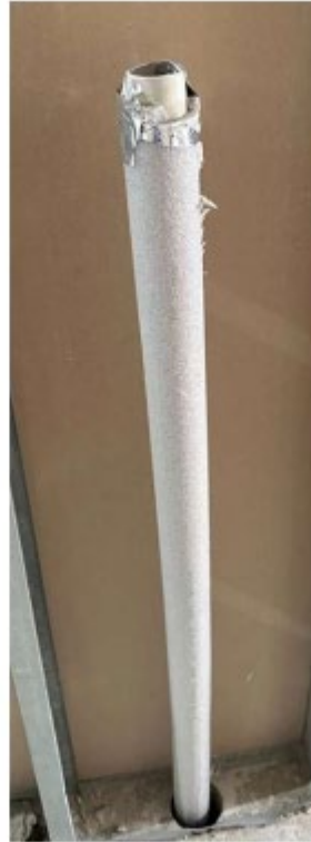
REDE DE DRENO
