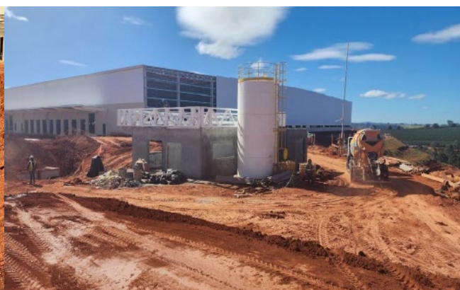
Área Reciclagem, reservatório de água de reuso e ETE.
