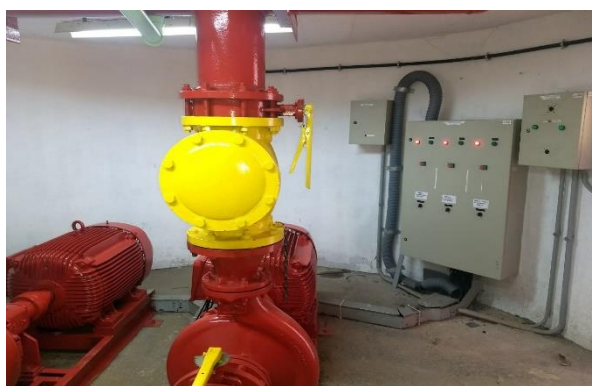
Sala Bomba de Incêndio pós reforma
