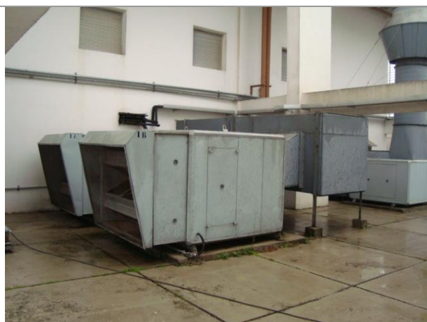
Vista Geral Exaustores
