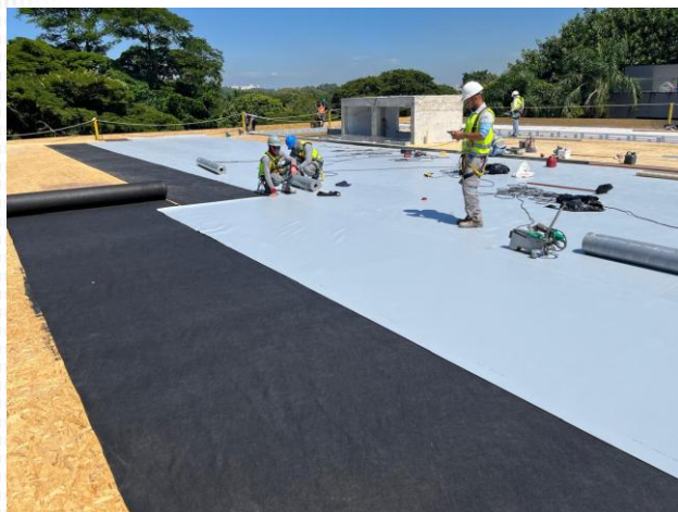
Manta TPO da cobertura
