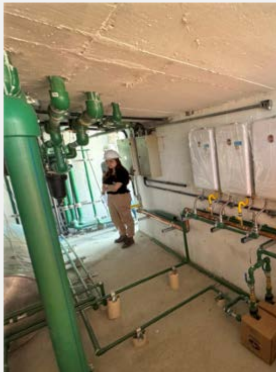
Central de aquecimento Bloco C (set/25)
