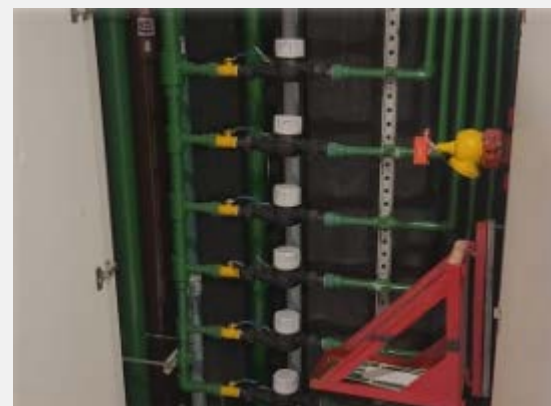
Medidores Bloco B (out/25)
