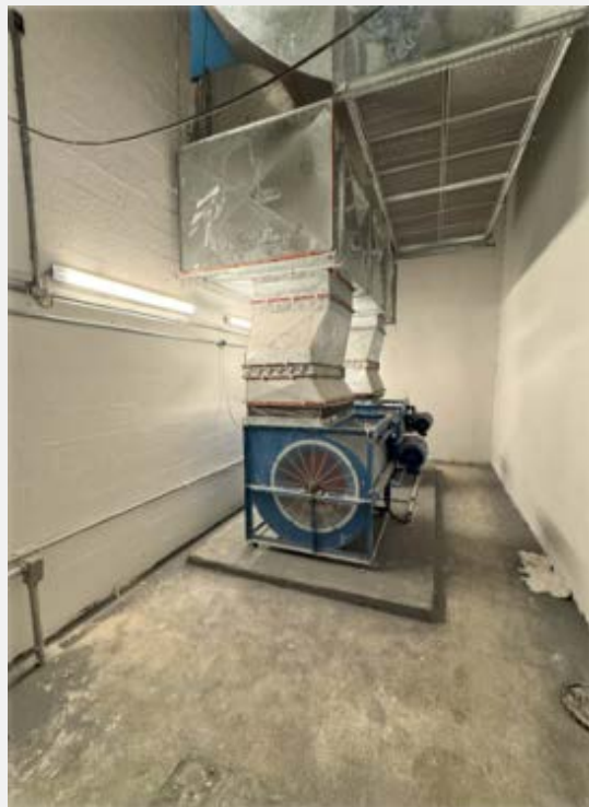
Sala de Pressurização Bloco A (set/25)
