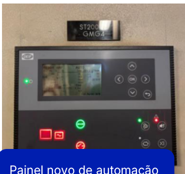
Painel novo de automação da usina durante os testes
