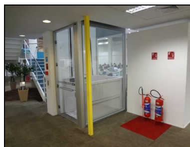
Elevador interligando as unidades da Vale S.A.
