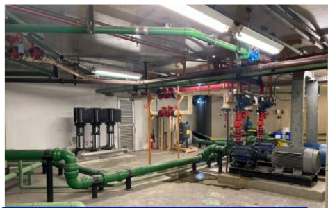
Sala de abastecimento de água potável após a revisão do sistema
