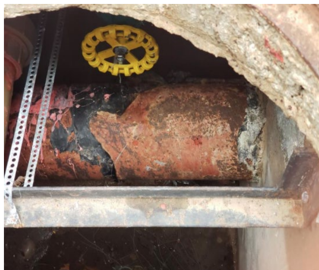
Oxidação na tubulação.
