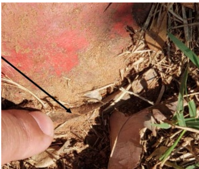
Falta de aderência na fita anticorrosiva.
