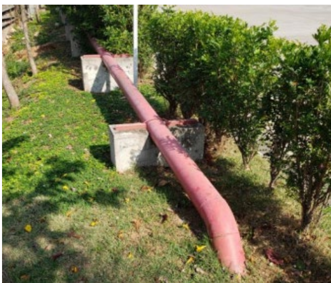
Rede principal de incêndio danificada.
