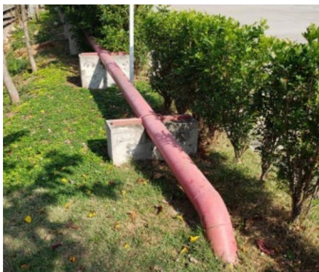
Rede principal de incêndio danificada.
