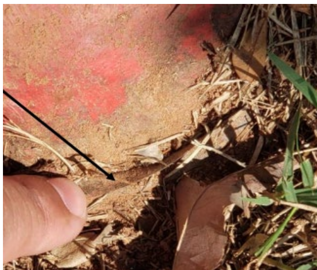
Falta de aderência na fita anticorrosiva.
