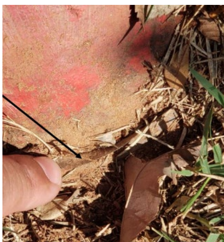
Falta de aderência na fita anticorrosiva.
