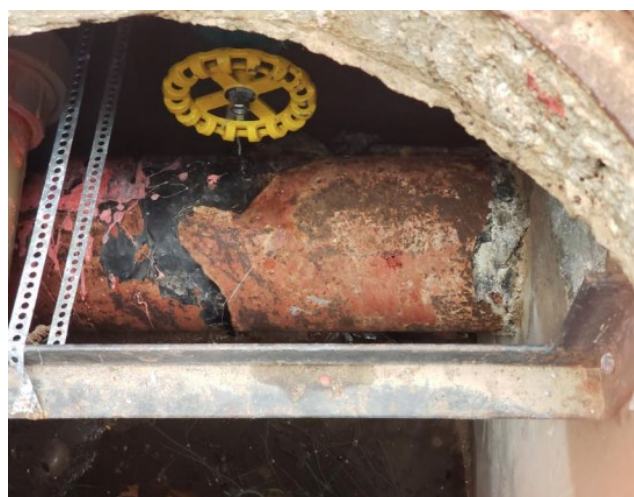
Oxidação na tubulação.
