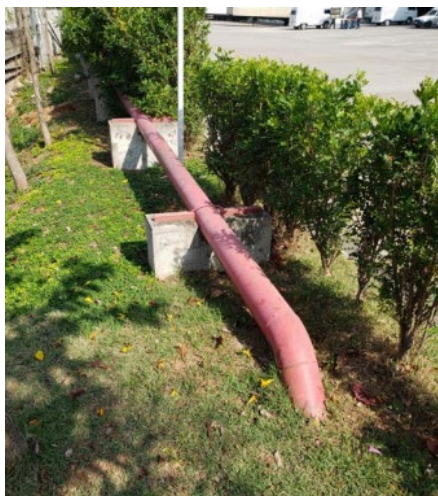
Rede principal de incêndio danificada.
