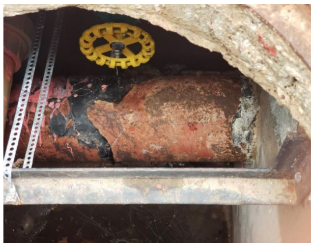
Oxidação na tubulação.
