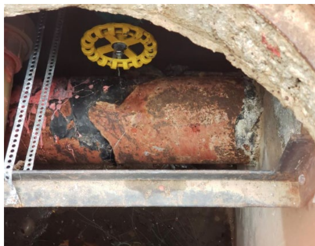
Oxidação na tubulação.
