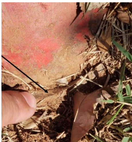
Falta de aderência na fita anticorrosiva.
