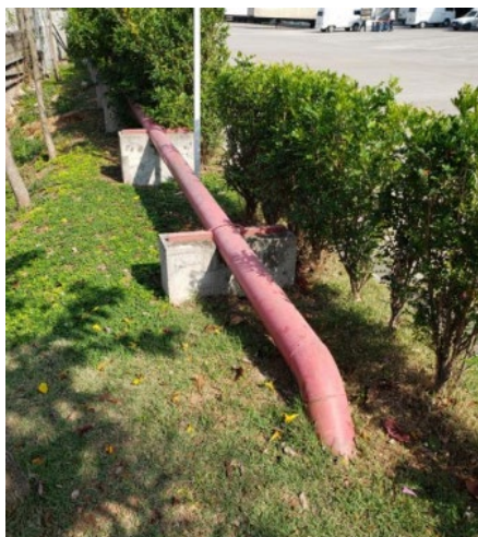
Rede principal de incêndio danificada.
