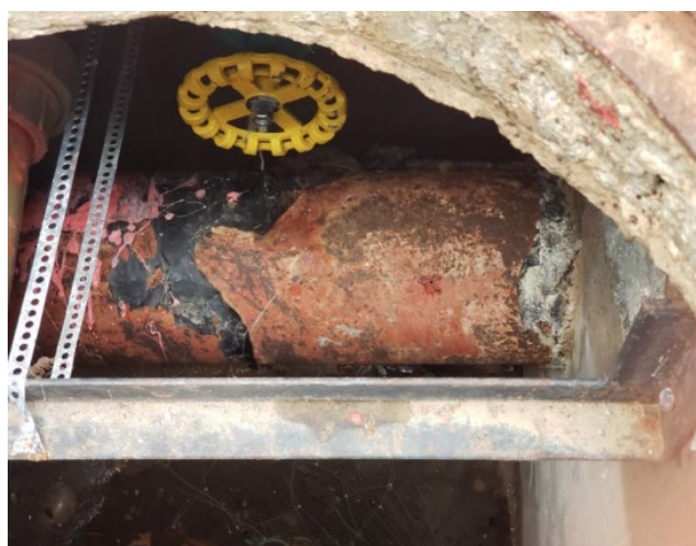
Oxidação na tubulação.
