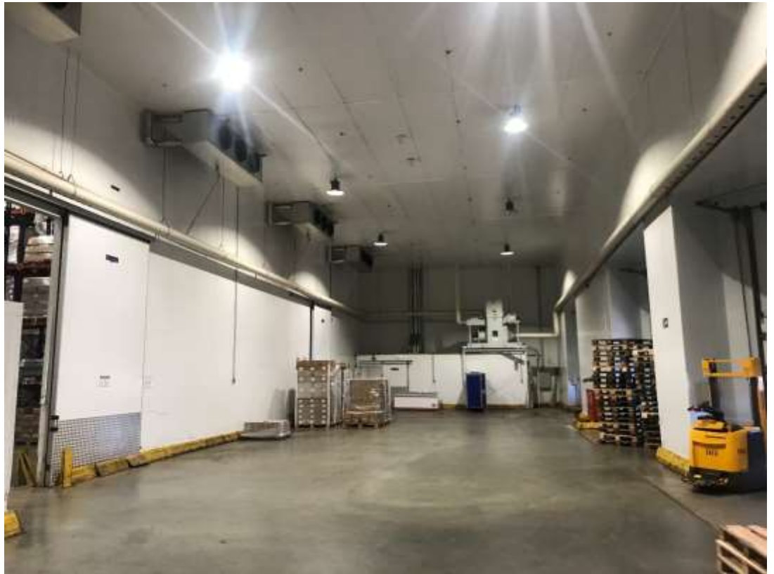
VISTA DAS ANTE-CÂMARAS REFRIGERADAS
