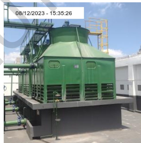
Casa de maquinas (Torre de resfriamento)
