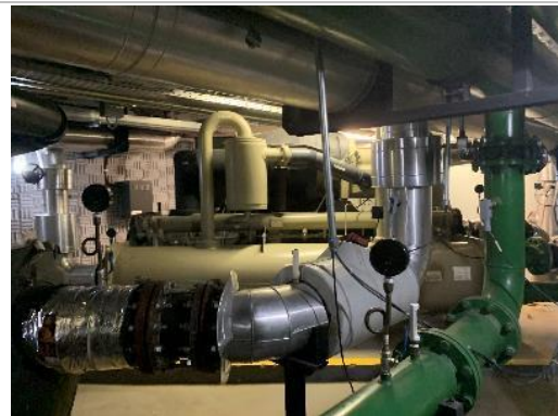
Central de água gelada
