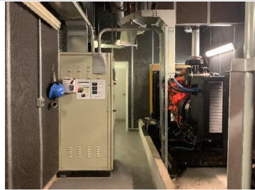
Sala de geradores
