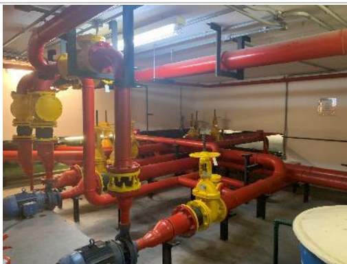
Casa de bombas destinada a incêndio
