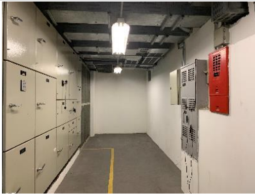
Quadros de energia
