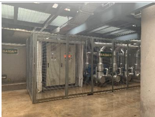
Central de água gelada somente do Albert Einstein
