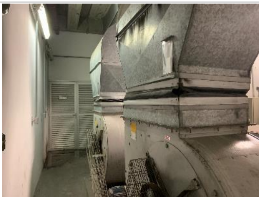
Sala de exaustores
