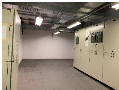
Painéis de energia
