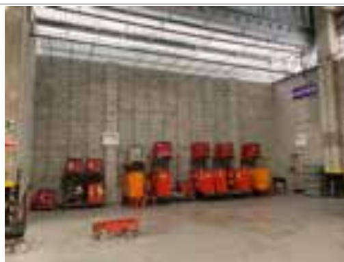
Casa de baterias
