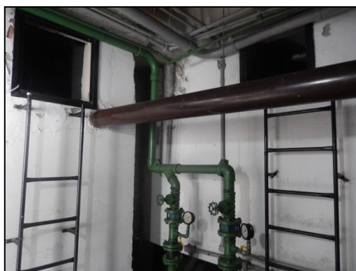
Área técnica (subsolo)
