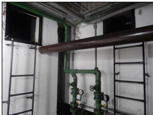
Área técnica (subsolo)
