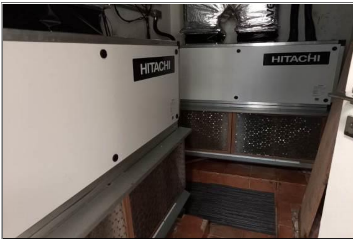
CONJUNTO 08 – SALA DE MÁQUINAS
