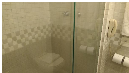
Box do banheiro – unidade 905
