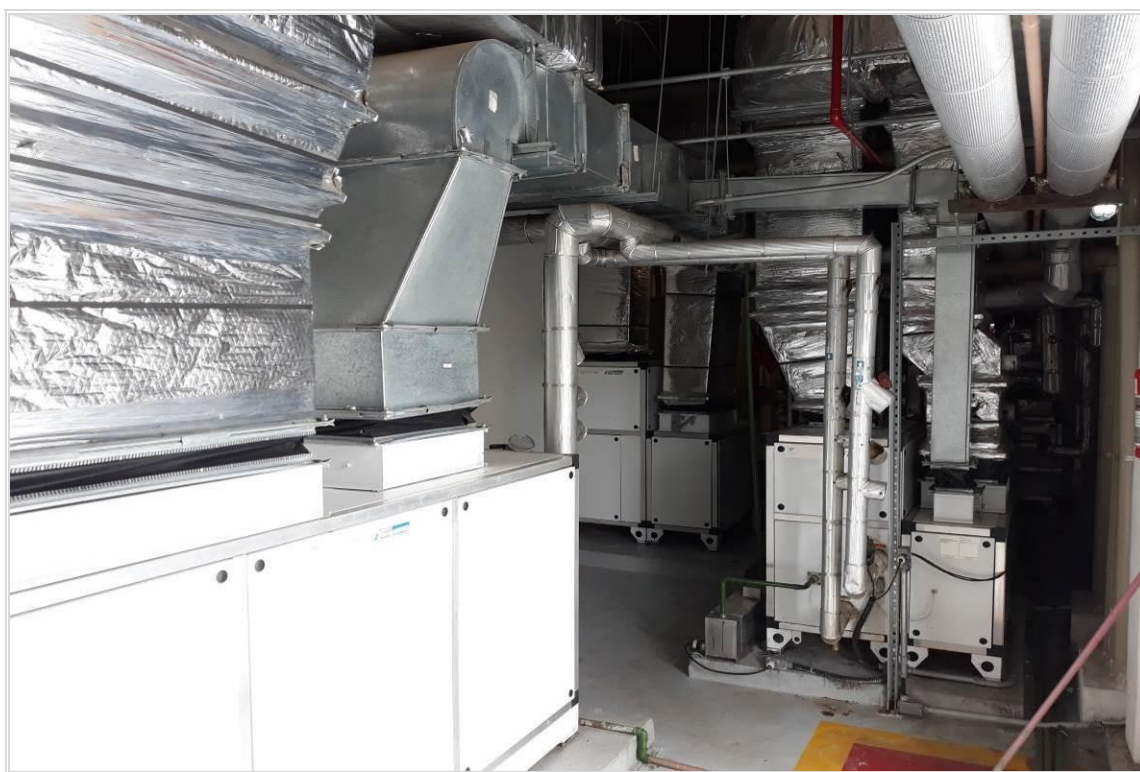
CASA DE MÁQUINAS
