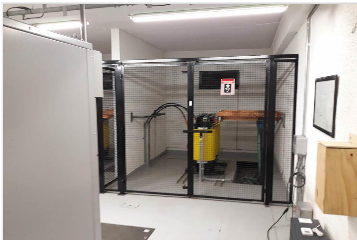
CABINE DE TRANSFORMAÇÃO
