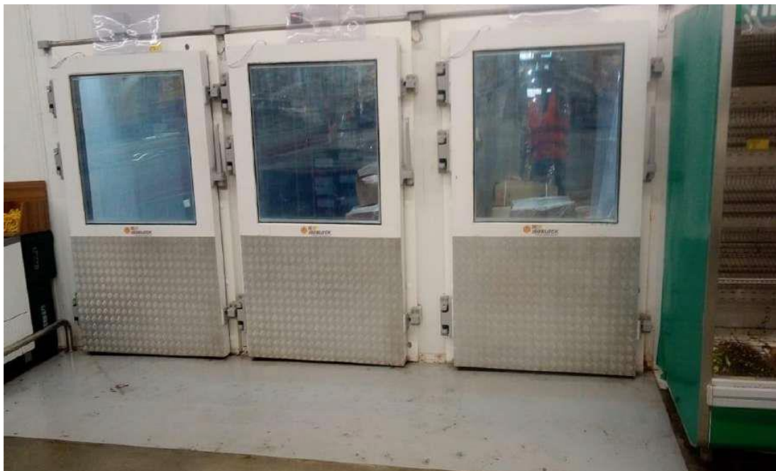
ÁREA CLIMATIZADA – CÂMARAS FRIAS
