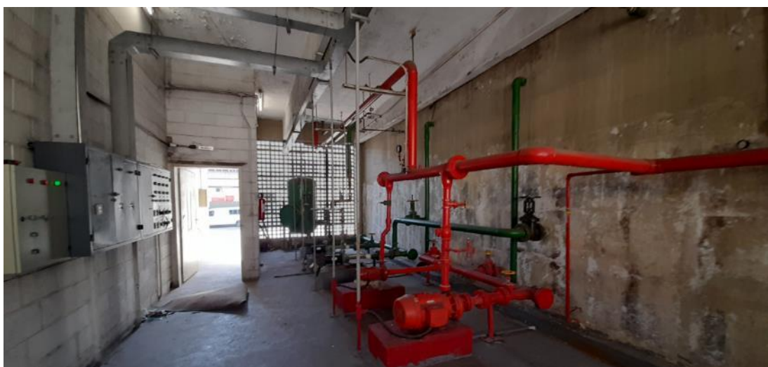
ÁREAS TÉCNICAS/TUBULAÇÃO DE RECALQUE
