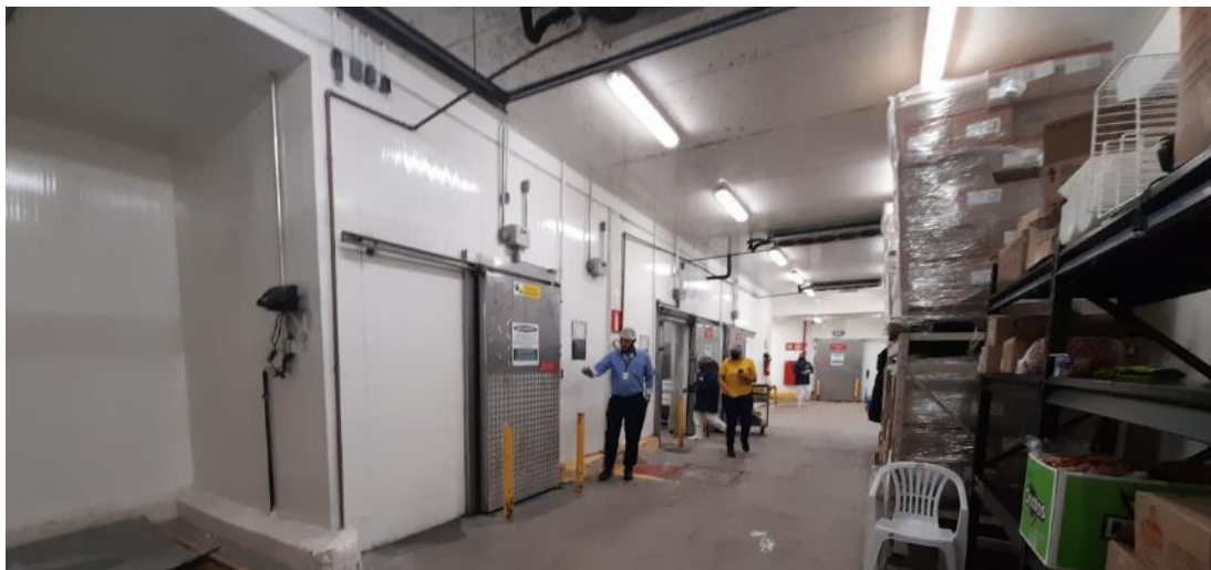
ÁREA DAS CÂMARAS FRIAS
