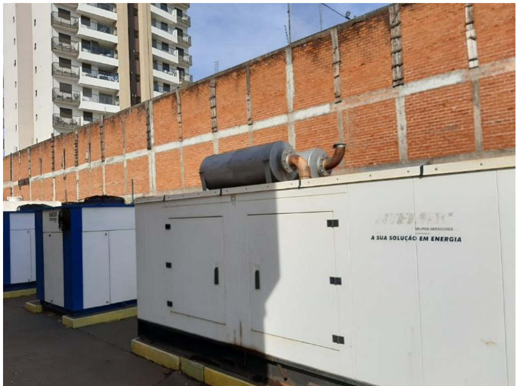
VISTA DA ÁREA EXTERNA, GERADORES
