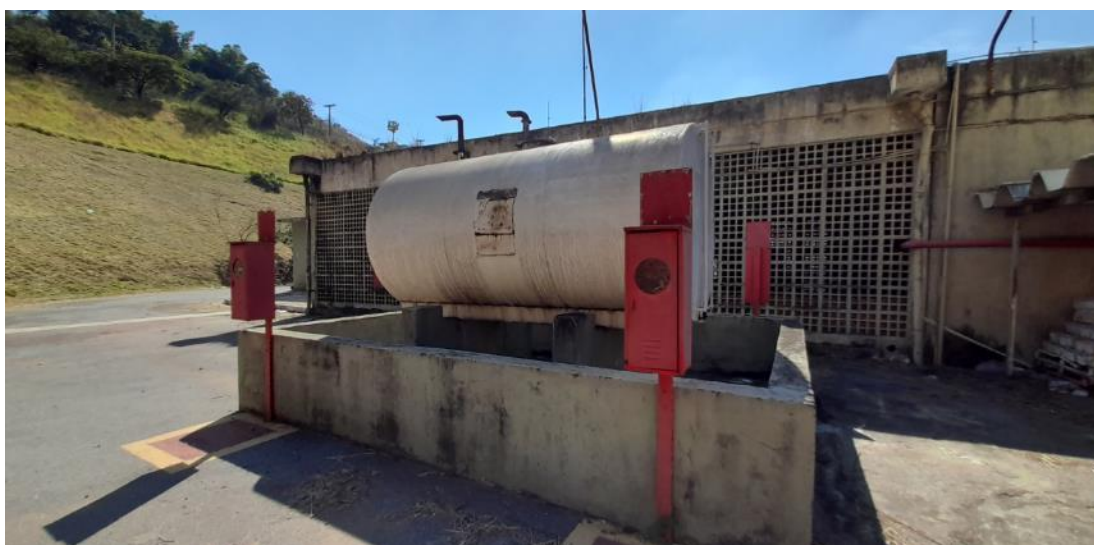
RESERVATÓRIO DO GERADOR
