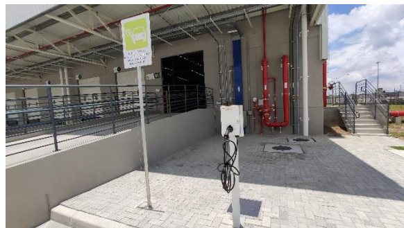
Ponto de recarga de carros elétricos
