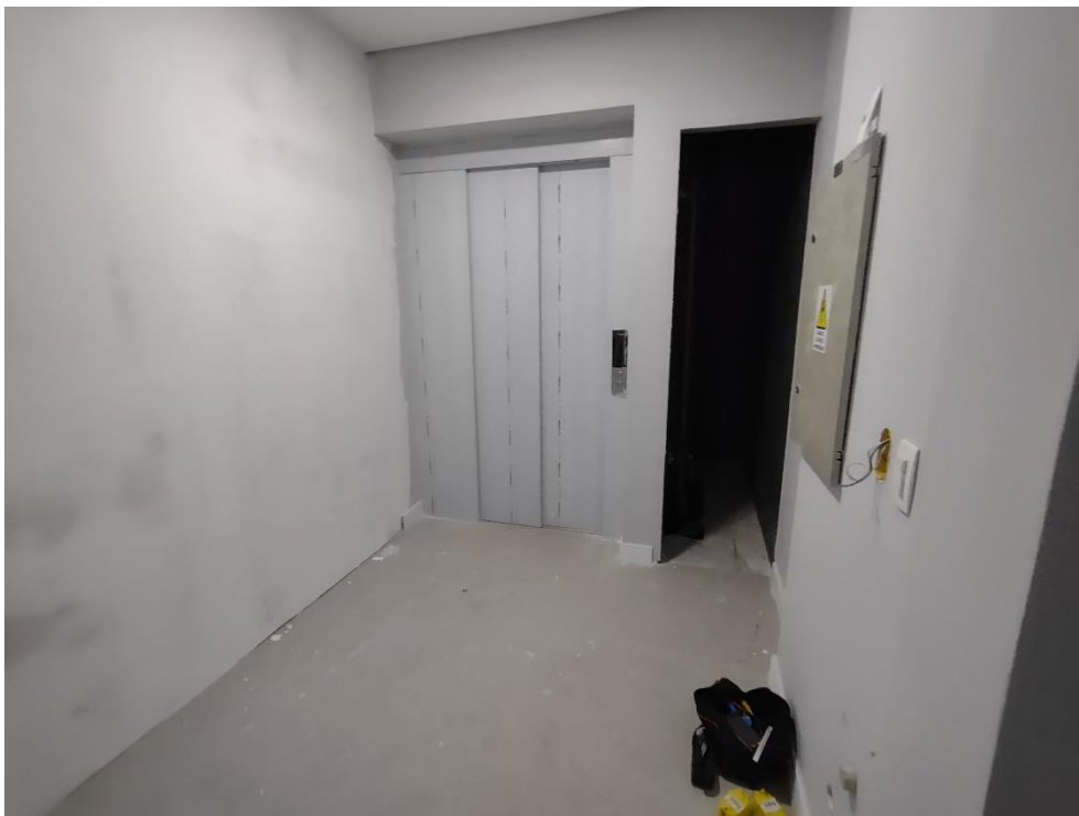
1º andar hall dos elevadores
