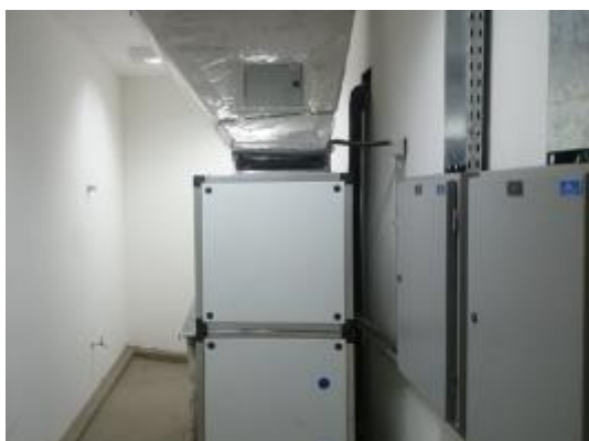
Shaft de Ar condicionado
