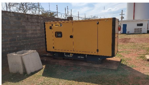
Gerador do escritório e portaria
