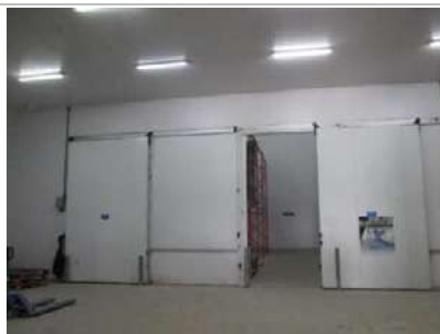
Detalhes da Câmara Frigorífico
