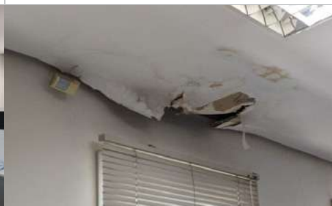
Sala Principal – Admin. – 2º Andar
