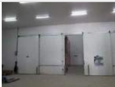
Detalhes da Câmara Frigorífico
