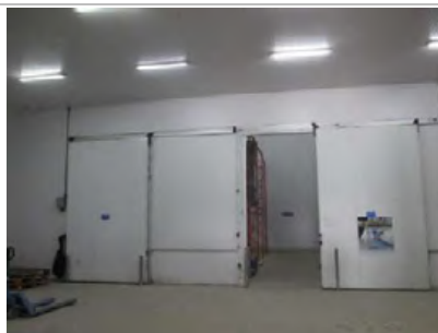
Detalhes da Câmara Frigorífico
