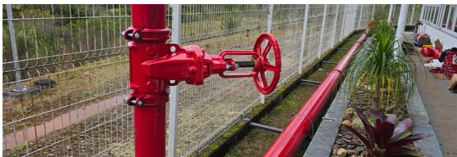
Renault - Sistema de Combate a Incêndio
