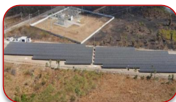
Amontada II ENEL - CE 1,2 MWp
