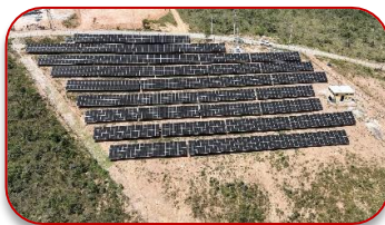
Malbec Cemig - MG 0.8 MWp
