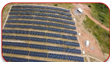
Carmo FE Light - RJ 5,3 MWp
