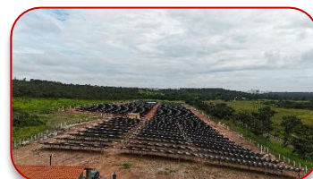
Catena Cemig - MG 3,6 MWp
