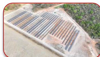
Canoa Quebrada Energisa - MT 6.1 MWp
