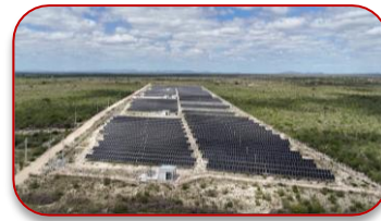
Petrolina Neoenergia - PE 5.0 MWp
