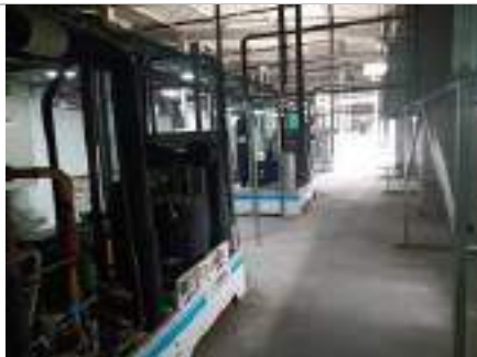
Sala de máquinas
