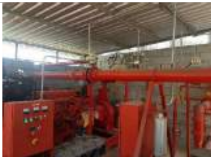
Sala de Bombas
