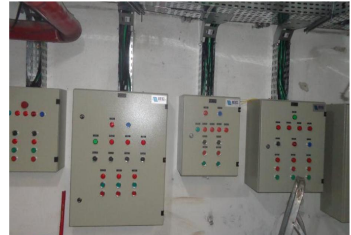
Centro de controle
