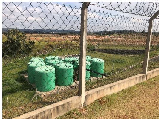
ESTAÇÃO DE TRATAMENTO (ETE)
