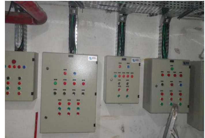
Centro de controle
