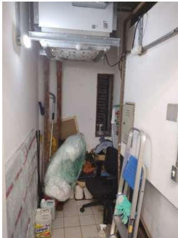
Conjunto nº 31 – sala do ar-condicionado
