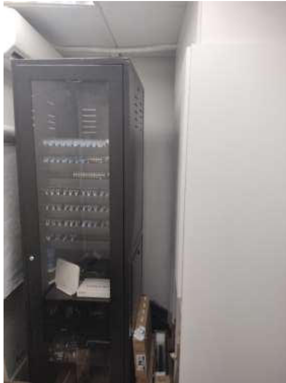
Conjunto nº 31 – servidor
