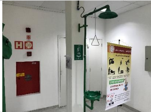
Chuveiro de descontaminação
