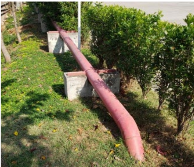
Rede principal de incêndio danificada.
