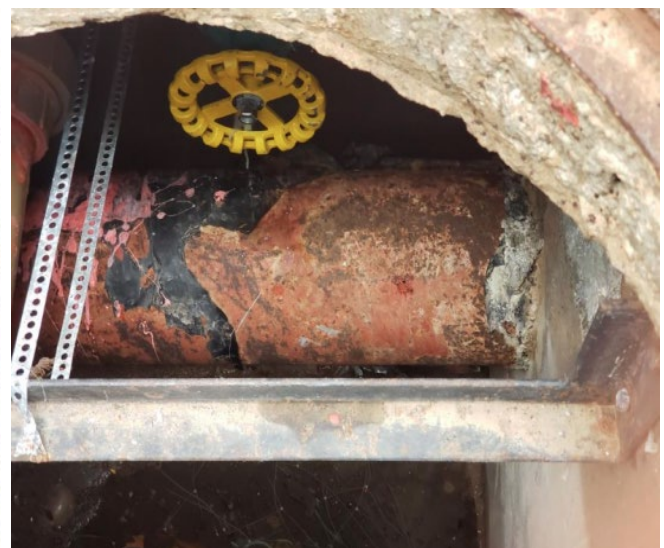
Oxidação na tubulação.
