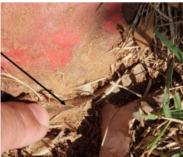
Falta de aderência na fita anticorrosiva.
