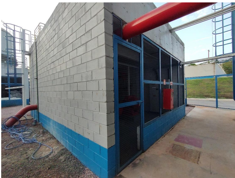
Vista Geral da Área de Rede de Combate e Incêndio
