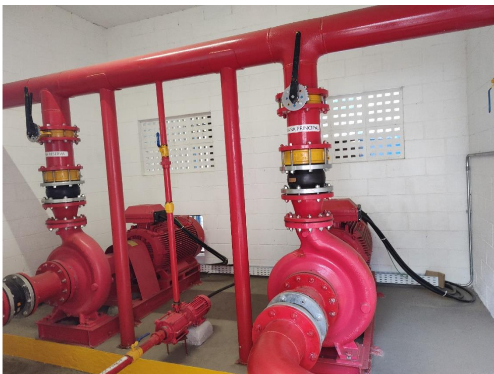
Vista Geral da Área de Rede de Combate a Incêndio
