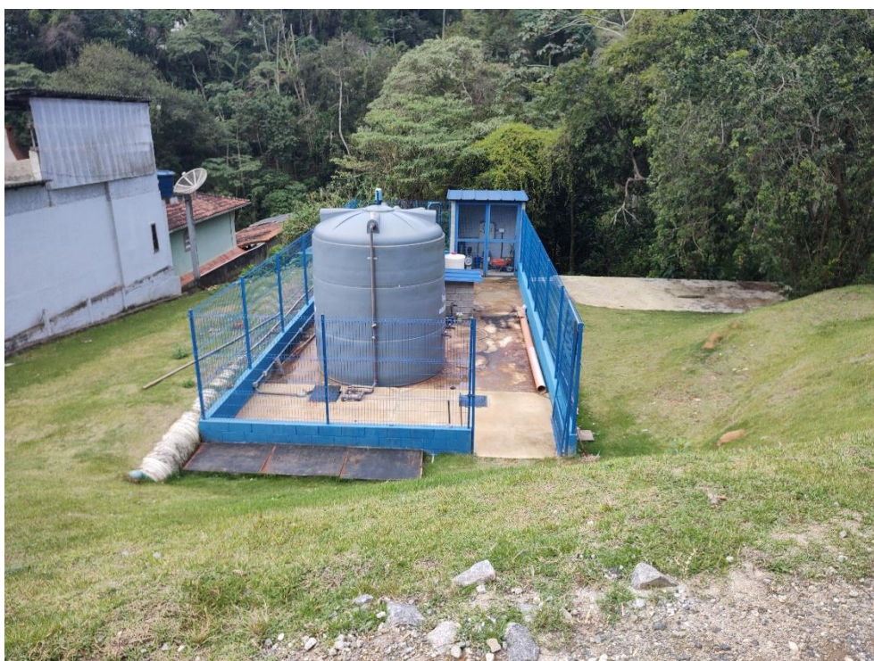
Vista Geral da Área Técnica
