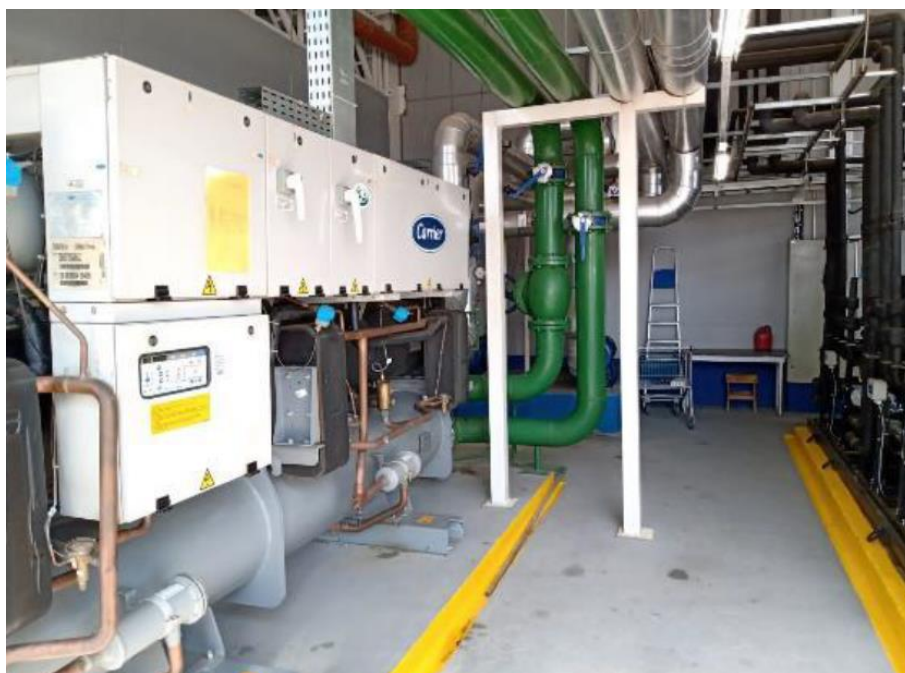
Vista Geral da casa de geradores
